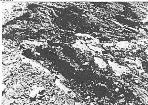
Foto 5.- Rápida meteorización en las pizarras situadas en los frentes de los taludes.
